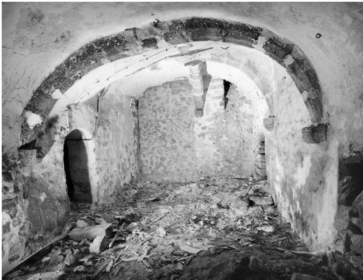
La cave : vue d'ensemble du berceau avec arcs doubleaux, depuis le nord (vers la rue).
